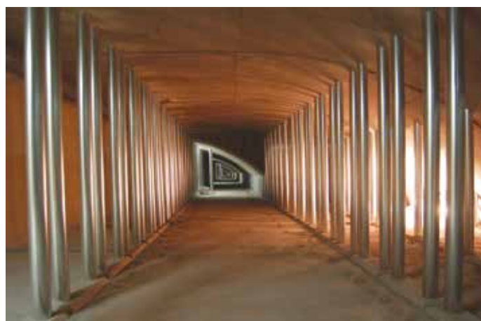
12. Il condotto dell'aria viziata in calotta presso la galleria Valsassina
