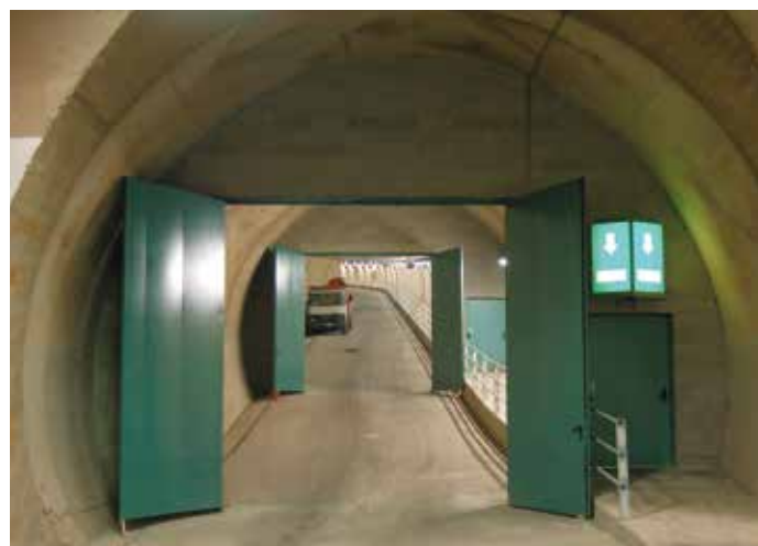
1. La via di fuga della galleria Passo del lupo sulla S.S. 36 Racc "del Lago di Como e dello Spluga"
