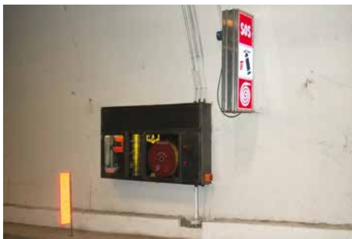
2. Impianti SOS e antincendio presso la galleria Valsassina sulla S.S. 36 "del Lago di Como e dello Spluga"
